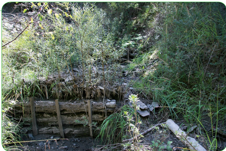
Figure 2.12. La présence de végétation sur les versants de la ravine a une influence positive sur la reprise et la survie des boutures.
