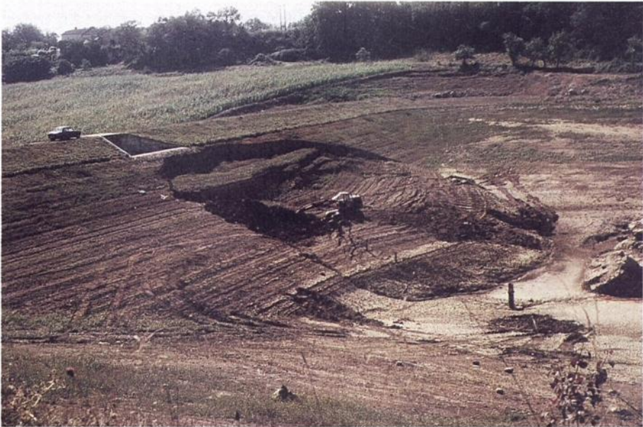
Glissement du talus amont d'un barrage en terre de 17 m de hauteur. Cet incident est survenu lors de la quatrième vidange de la retenue destinée à l'irrigation. On notera la progression du phénomène démarré à la base du talus et qui s'est stabilisé à l'aplomb du seuil déversant.
